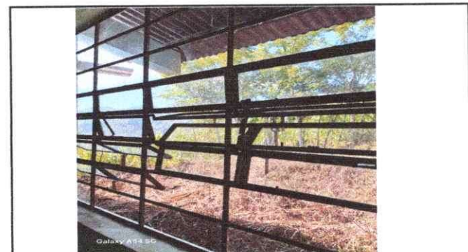
Foto 4: Reponer los vidrios quebrados
